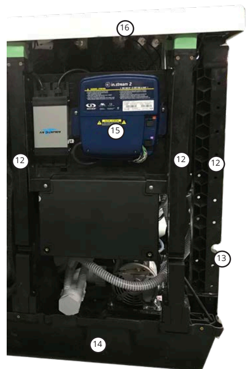
Motorruimte aan de hoekkant (links vóór)
