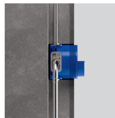
Installation encastrée dans le mur
